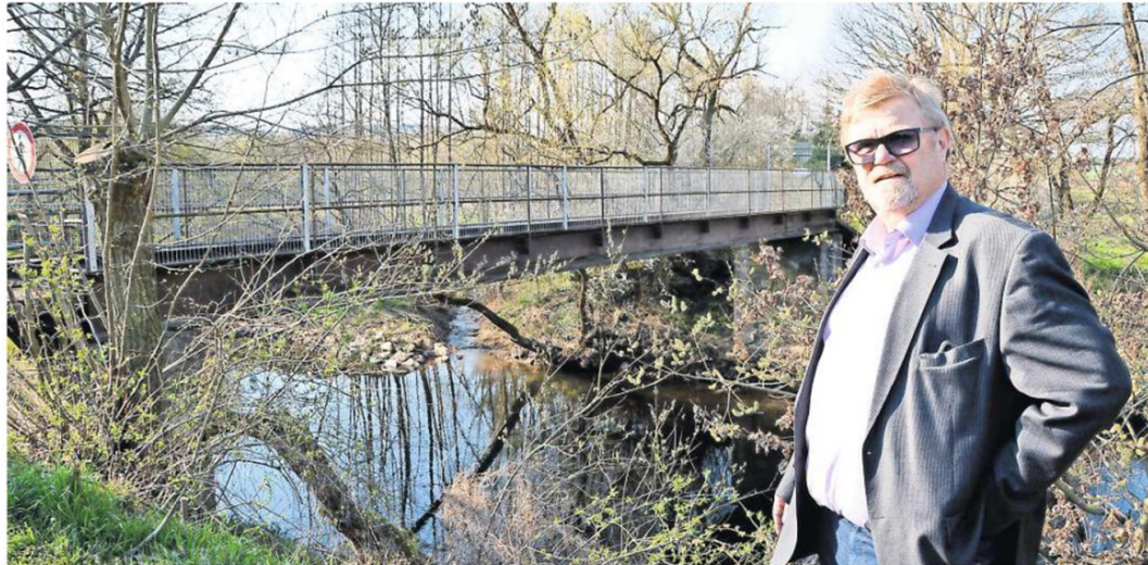
Isenbergs Brücke in Goffelden ist marode und musste gesperrt werden. Bürgermeister Manfred Apell wirbt für einen Neubau, manche Bürger lehnen den aber ab.
