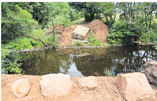
Nur noch letzte Reste der Pfeiler lagen gestern am Ufer.
